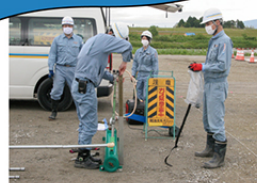
①被害にあったガス設備の 応急処置
